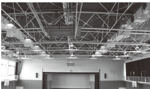
●老朽化する飲む応援スポーツアリーナ（スポーツセンター）の天井
