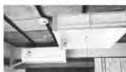
▲エアコン・照明器具
